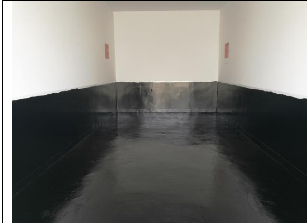
危废暂存库内部
