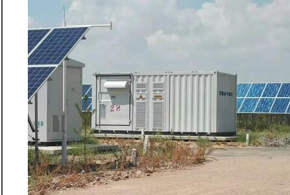
逆变器、变压器密闭安置运行
