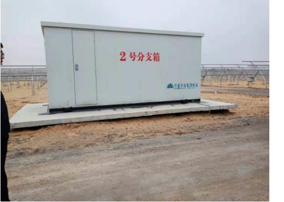
封闭的逆变器
